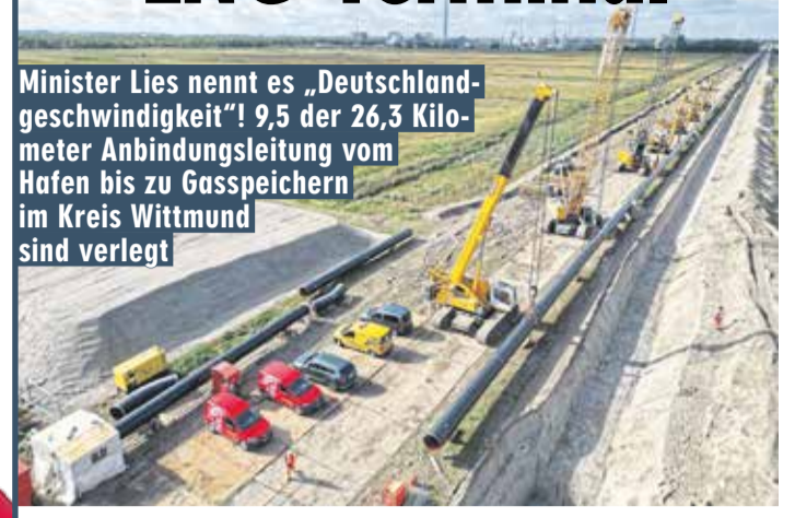
Minister Lies nennt es „Deutschland-geschwindigkeit“! 9,5 der 26,3 Kilometer Anbindungsleitung vom Hafen bis zu Gasspeichern im Kreis Wittmund sind verlegt
